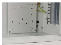
Pusta blacha montażowa
